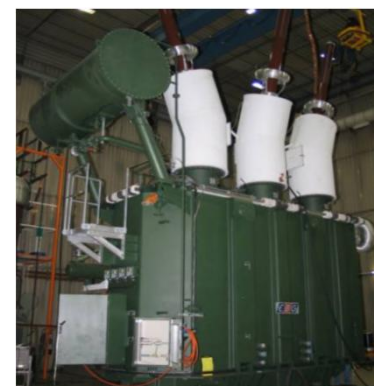
采用MIDEL7131合成酯 地下厂房电力变压器
